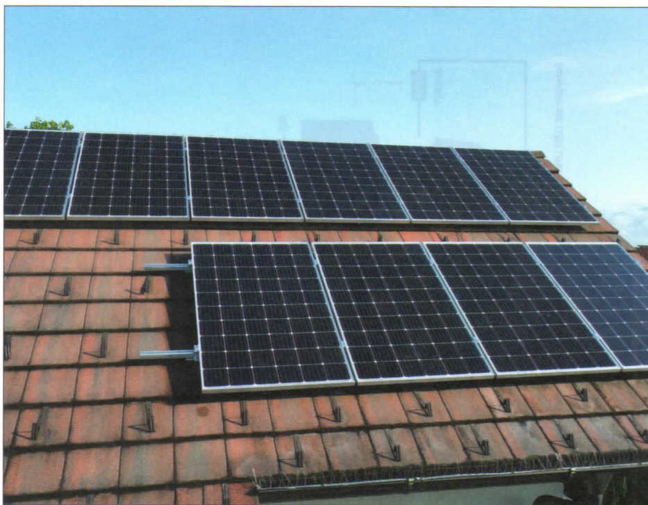
Paneli so na strehi! Vir: avtor
