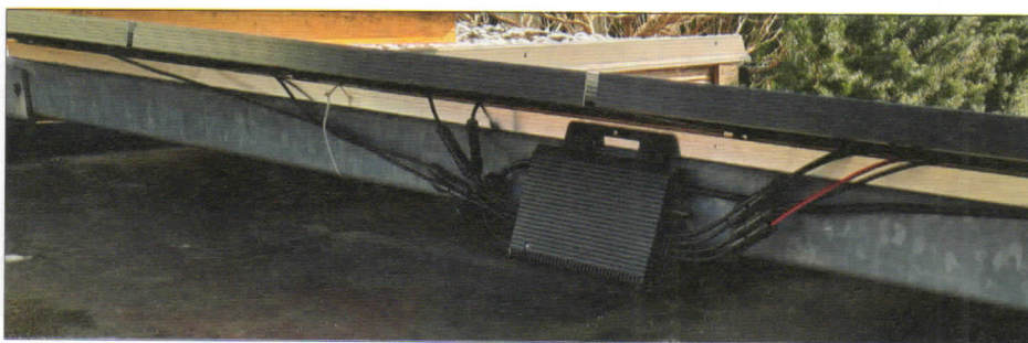
Štirikanalni mikro-razsmernik Hoyt Miles HM-1500, zmontiran pod paneli
